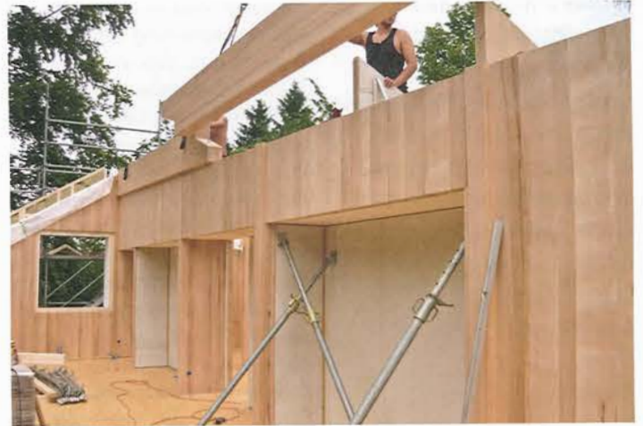
Bei den Wänden kam das von Hermann Blumer entwickelte Top Wall-System zum Einsatz. Foto: Caspar Schärer
